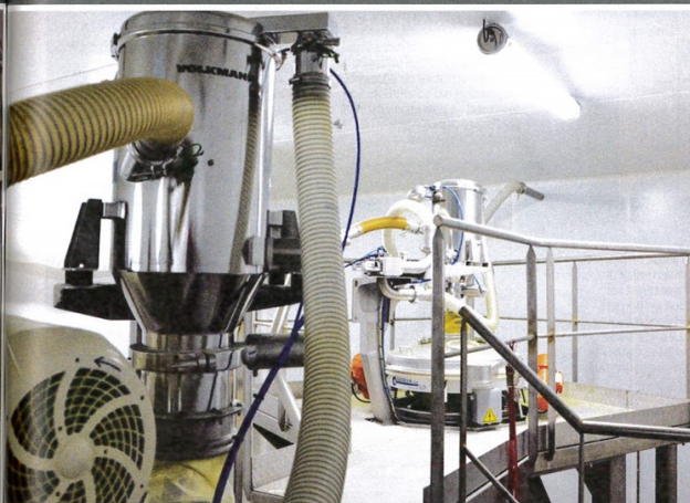
➤ Transfert. Le système est composé de deux transferts pneumatiques (Volkman). Le premier reprend les matières premières au vide-sacs et les transfère dans le mélangeur (Hosokawa Micron). Le second amène le produit mélangé au tamisage (Sodeva) et au conditionnement.
