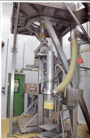
➤ Conditionnement. Le système délivre deux sacs de 25 kg par min ou 3 t en big-bags par heure. Entre les tuyauteries, des manchettes BFM Fitting évitent le recours aux boulons.
